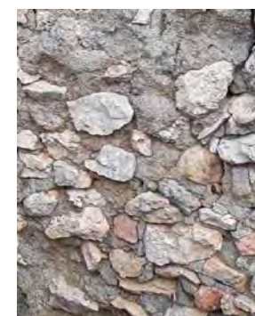
2. Revoco perdido, juntado entre mampuestos existente.
