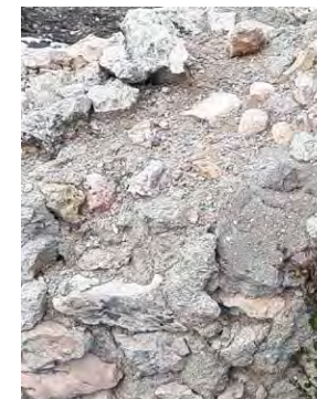
4. Pérdida importante de mampuestos.
