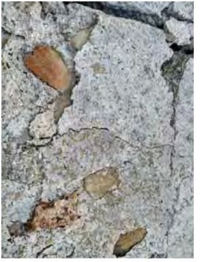
1. Revoco existente pero degradado.
